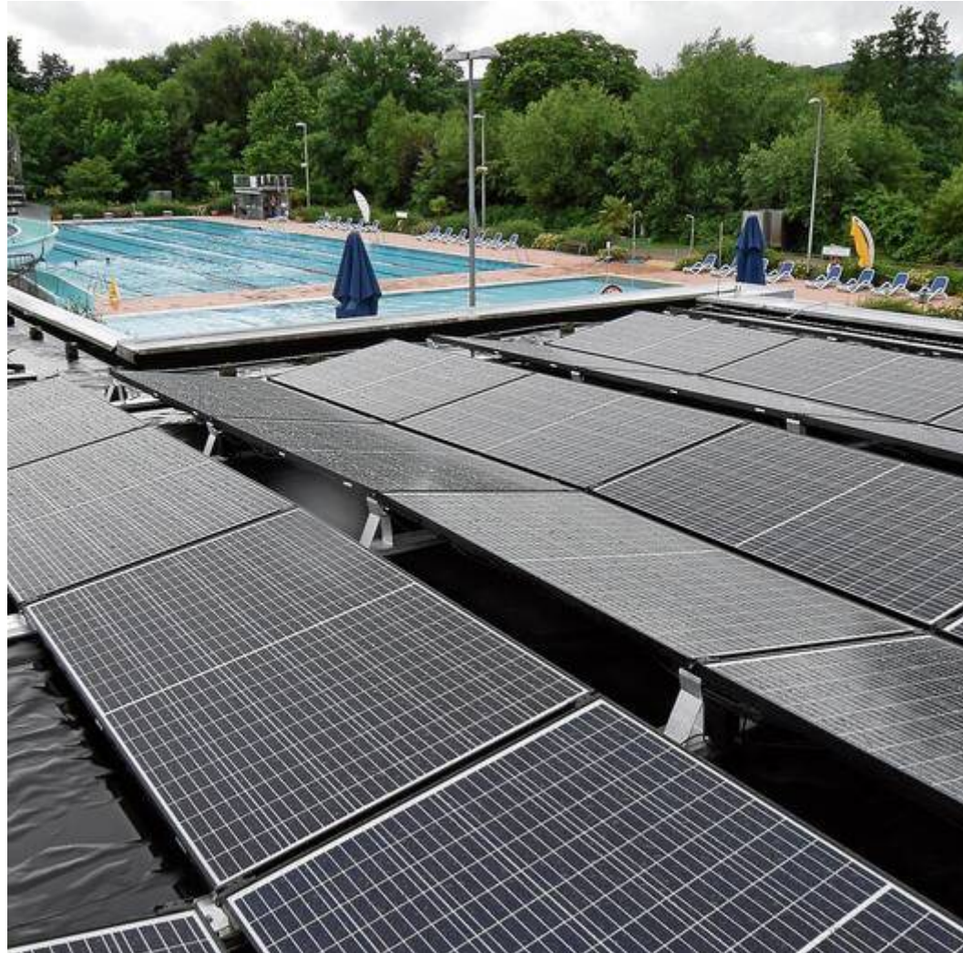
299 Photovoltaikanlagen gibt es in Bad Pymont – wie hier auf dem Dach des Hallenbades. Die Energiegenossenschaft Pymont-Lügde sieht weiteres Potenzial.
